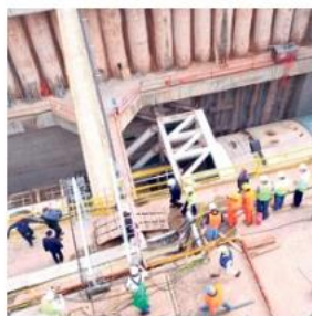
Obras en la localidad de Haedo, donde Macri dio inicio formal a la excavación del túnel que la unirá con Caballito.
